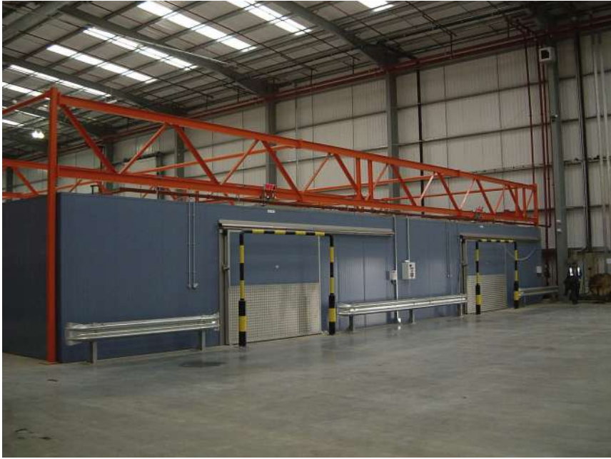
Figura 17.8 Compartimento refrigerado dentro de um armazém para uma variedade de produtos congelados e refrigerados (Star Refrigeration).
